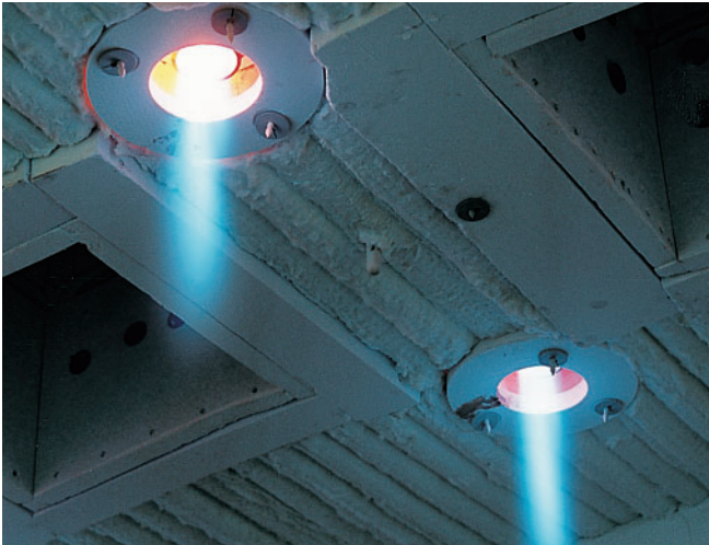
Deckenbefuerung mit BIC-Brennern (Kromschroder)
